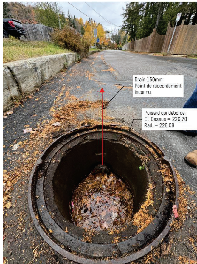
Figure 6 - Puisard #1 qui déborde sur le chemin Plouffe
